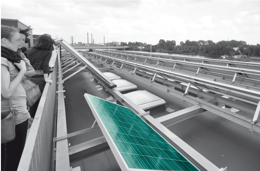
Abb. 76 Beste Aussicht auf das PV-Kraftwerk Fig. 76 Best view of the PV power plant
