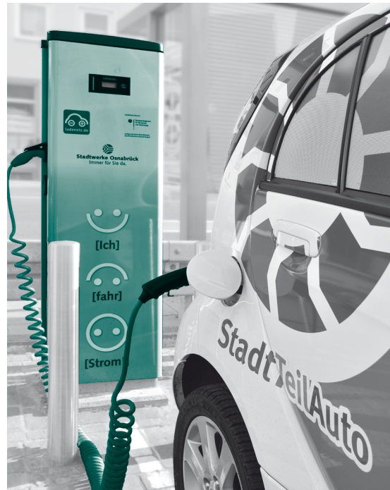
Abb. 97 Elektrofahrzeugladesäule Fig. 97 Charging points for electric vehicles
