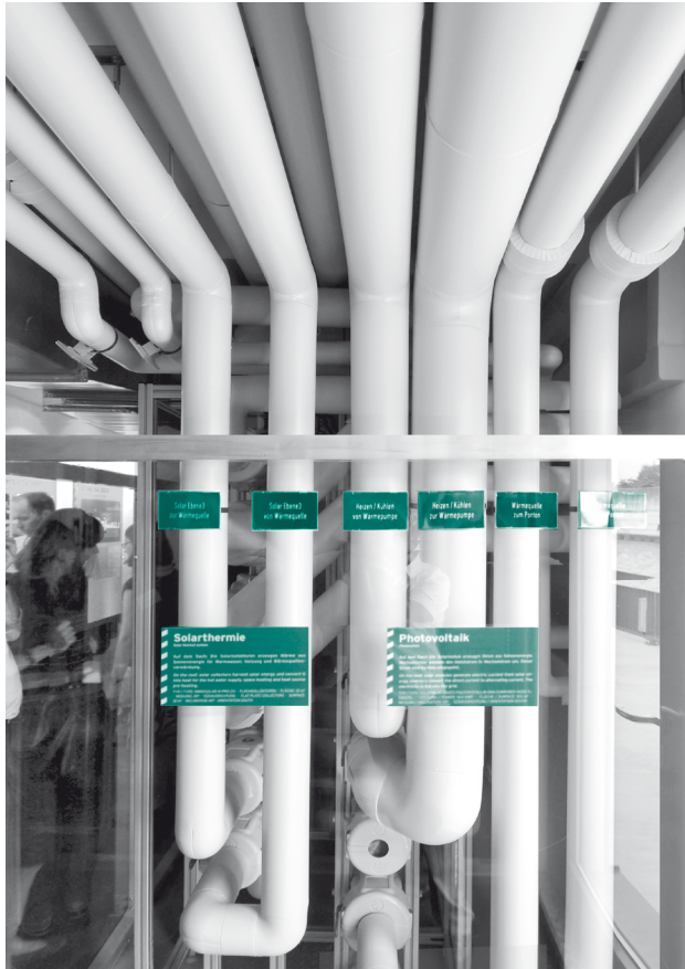
Abb. 91 Übersichtliche Leitungsführung mit Erklärungen (IBA Dock Hamburg) Fig. 91 Clearly arranged conduits with explanations (IBA Dock Hamburg)2
