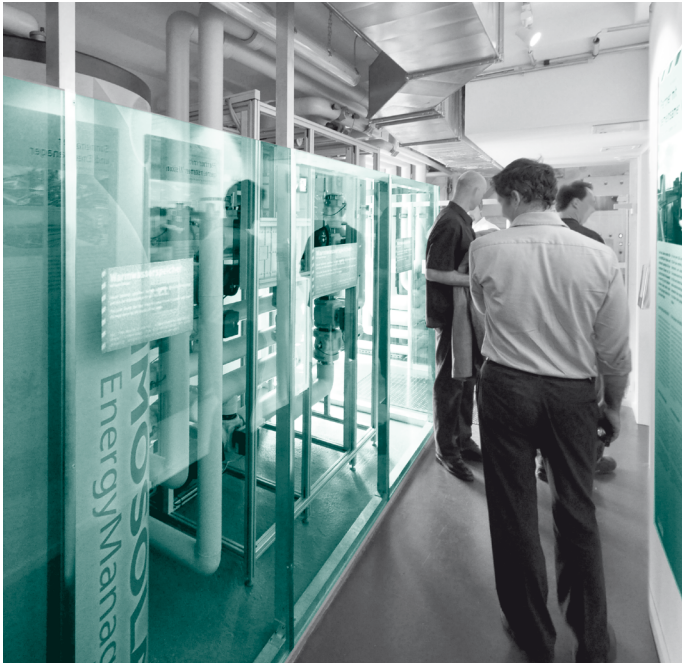
Abb. 89 Begehbarer Heiz- und Technikraum (IBA Dock Hamburg)
