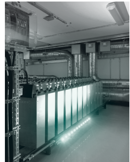
Abb. 81 Farbliche Unterschiede in der LED-Anzeige zeigen den Ladestand des Speichers
